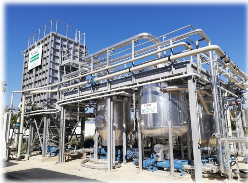
Figura 6. Planta de HT en la EDAR Copero (Sevilla)
